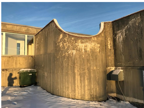
Mynd 20: Kaldur hluti veggja mikið skemmdur
