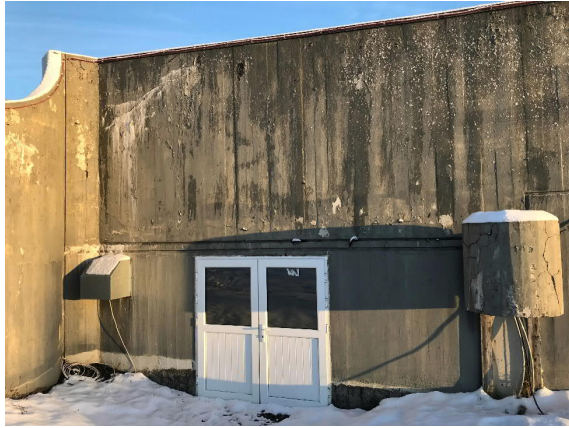
Mynd 22: Kaldur hluti veggja mikið skemmdur
