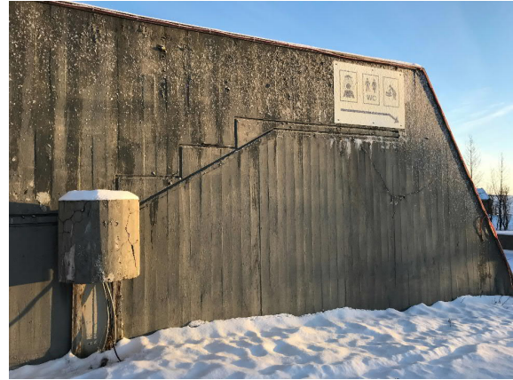
Mynd 23: Kaldur hluti veggja mikið skemmdur
