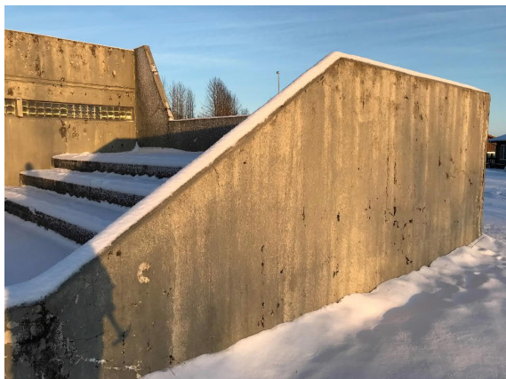
Mynd 62: Víða ummerki um of litla steypuhulu
