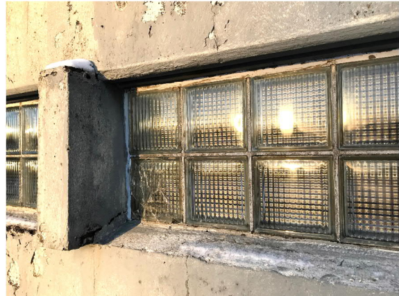
Mynd 25: Steyptar súlur þarfnast viðgerða
