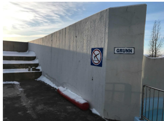
Mynd 47: Frostskemdir ofarlega á veggjum
