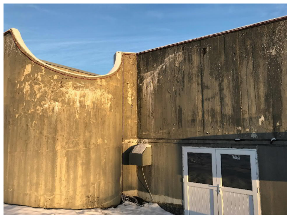
Mynd 21: Kaldur hluti veggja mikið skemmdur
