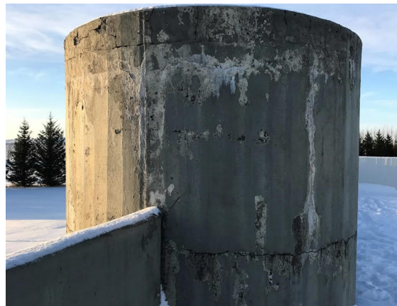
Mynd 51: Sprungin steypuskil og útfellingar
