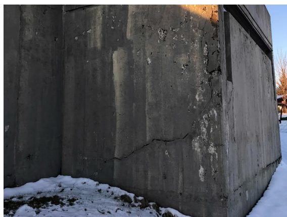
Mynd 30: Norðurhluti hliðar talsvert skemmdur
