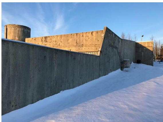
Mynd 64: Víða ummerki um of litla steypuhulu
