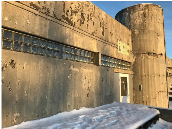
Mynd 24: Útveggjafirborð suðurhliða skemmt
