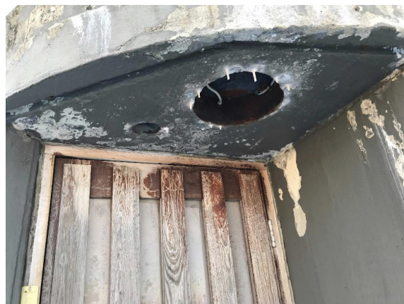
Mynd 53: Ryðgað loftunnarör við stigahús
