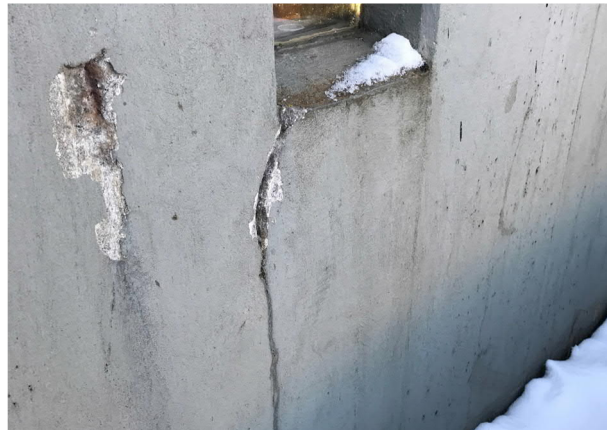
Mynd 3: Skemmd við glugga og út frá bendistáli
